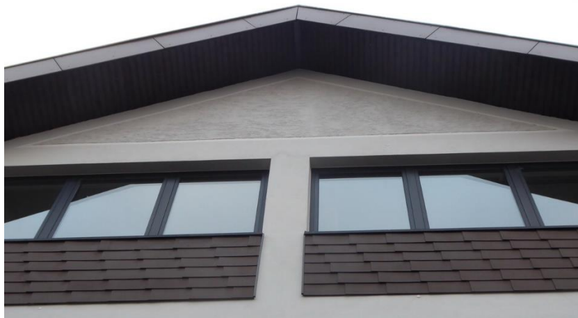
Foto 8 An der Fassade in der Bahnhofstraße gibt es keine Einschupfmöglichkeiten.
